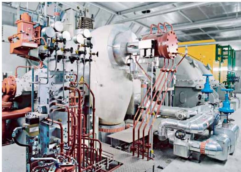
Турбоагрегат паровой турбины SST-600 в австрийской электростанции.
