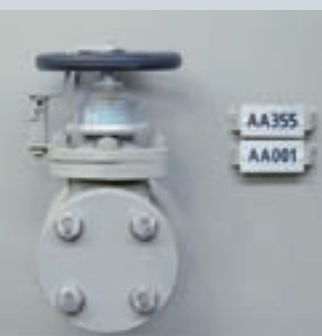
Válvula de vazamento
