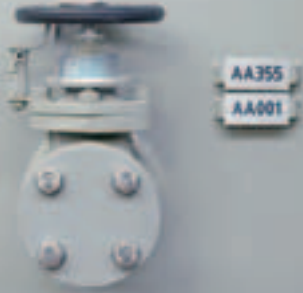
Válvula para drenaje
