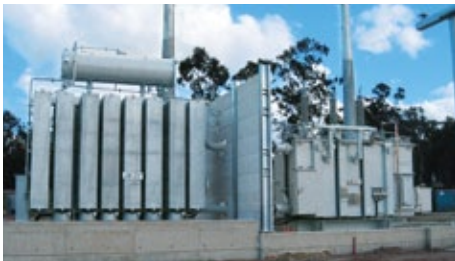
Электростанция «Пауэрлинк» (Австралия)
