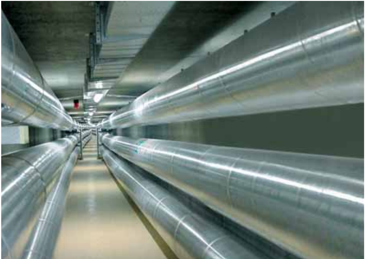
300-kV-GIL-Anlage (Betriebsspannung 220 kV) Palexpo, Genf, Schweiz, Inbetriebnahme 2001
