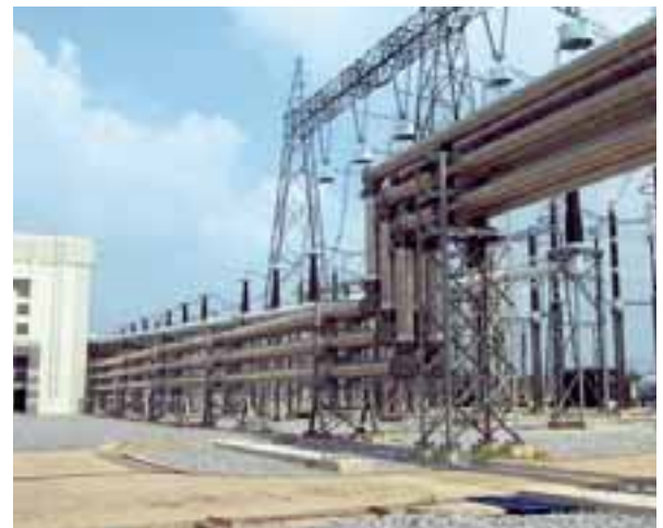
550-kV-GIL-Anlage Sai Noi, Bangkok, Thailand, Inbetriebnahme 2002
