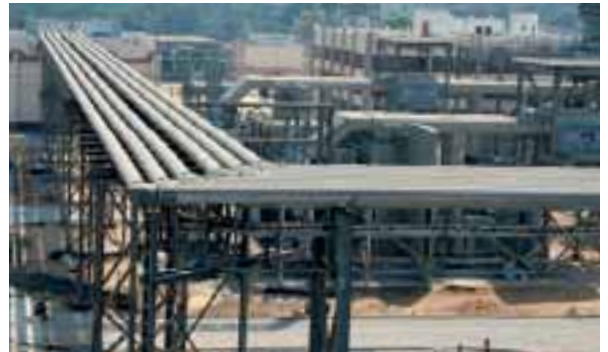
245-kV-GIL-Anlage Cairo North, Kairo, Ägypten, Inbetriebnahme 2004
