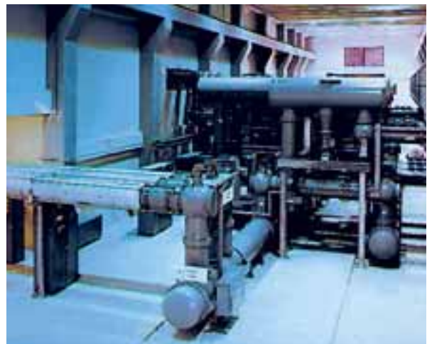
Anschluss der GIL an eine gasisolierte Schaltanlage, Deutschland, 1975
