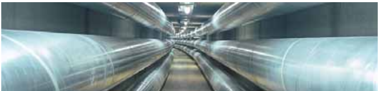
300-kV-GIL-Anlage Palexpo, Genf, Schweiz, Inbetriebnahme 2001, weltweit erste GIL mit Mischgasisolierung
