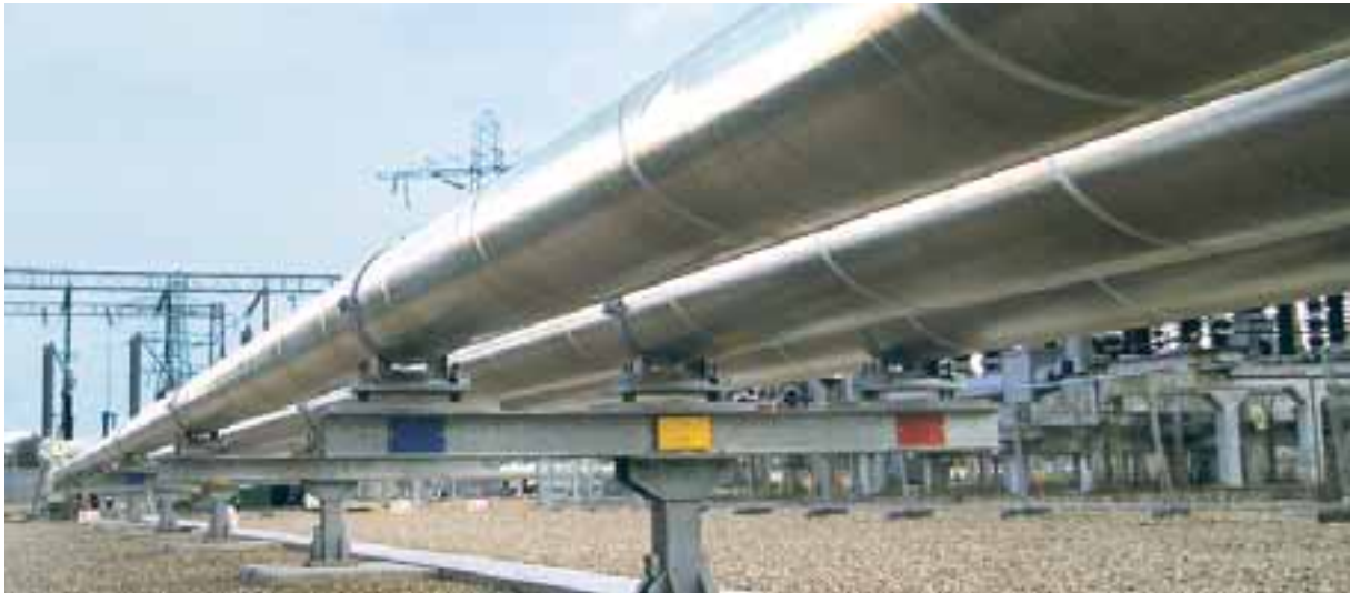
420-kV-GIL-Anlage Elstree, Großbritannien, Inbetriebnahme 2004
