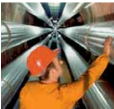
420-kV-GIL-Anlage Wehr, Deutschland, Inbetriebnahme 1975
