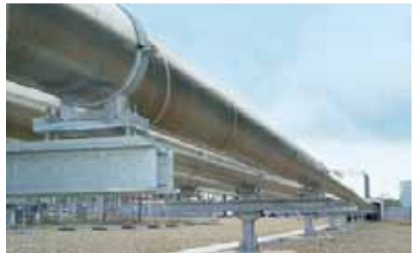
420-kV-GIL-Anlage Elstree, London, England, Inbetriebnahme 2004
