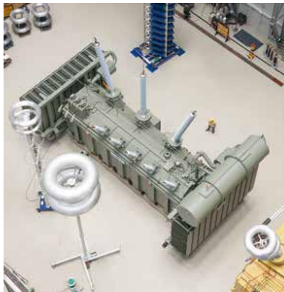
Transformator in der Höchstspannungs-Prüfhalle
